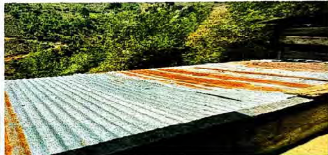
Foto 4: CONDICIÓN DEL TECHO DE LA COCINA
