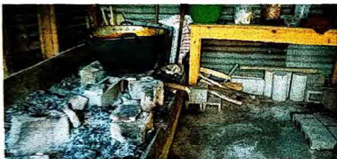
Foto 3: CONDICIÓN DEL POLLETÓN DE LA COCINA
